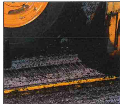
Photo 3 – Mise en œuvre déficiente
